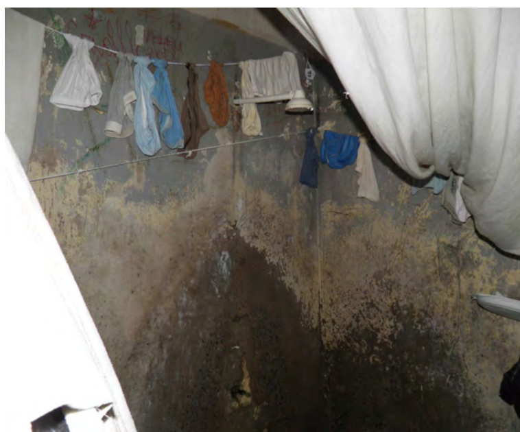
Imagem das paredes do banheiro de uma das celas do Centro de Detenção Provisória de Osasco II.
