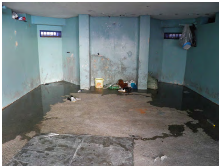
Demonstração da umidade em área de uso comum no Centro de Detenção Provisória de Praia Grande.
