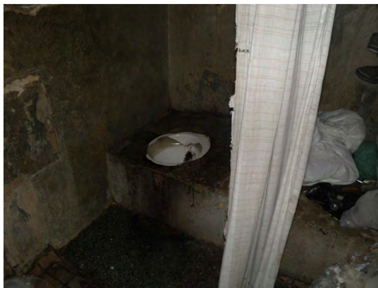
Imagem do vaso sanitário de uma cela do Centro de Detenção Provisória Chácara Belém I.
