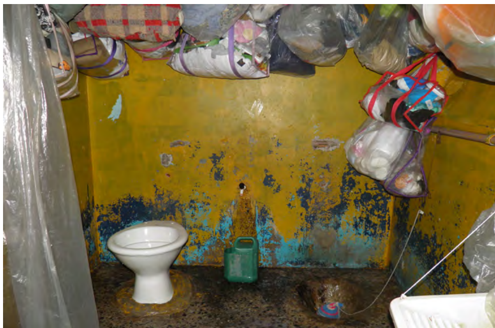
Instalações sanitárias em precárias condições no Centro de Detenção Provisória de Itapequerica da Serra.
