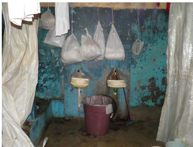
Imagem que comprova a precariedade das instalações hidráulicas, assim como o problema da umidade no Centro de Detenção Provisória de Diadema.
