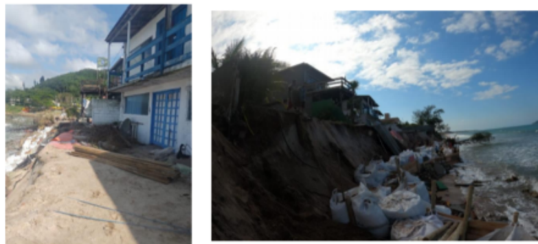
Figura 2. Imagens tiradas pelo Agravante no dia 29.05 demonstrando a iminência de risco de desabamento.
